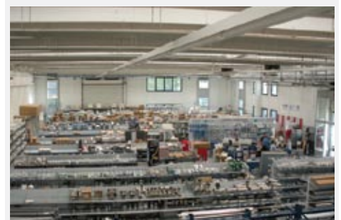
Impianto di illuminazione con controllo domotico F.M., controllo accessi, antincendio e antifurto
